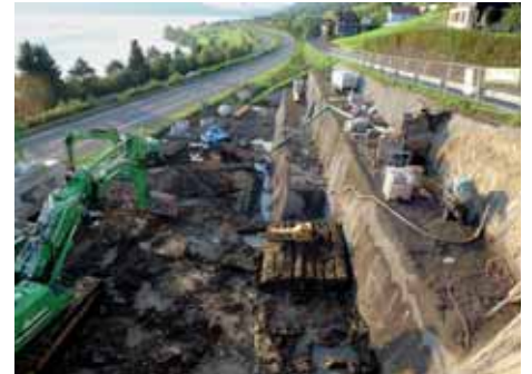
Die völlig durchnässte Baugrube.
