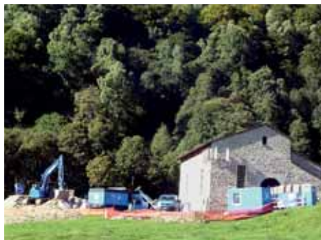
Kraftwerkzentrale Schlappin in Klosters.
