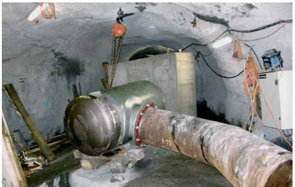
Stahlwasserbau/Drosselklappenkammer nach dem Staubecken Zwirgi.
