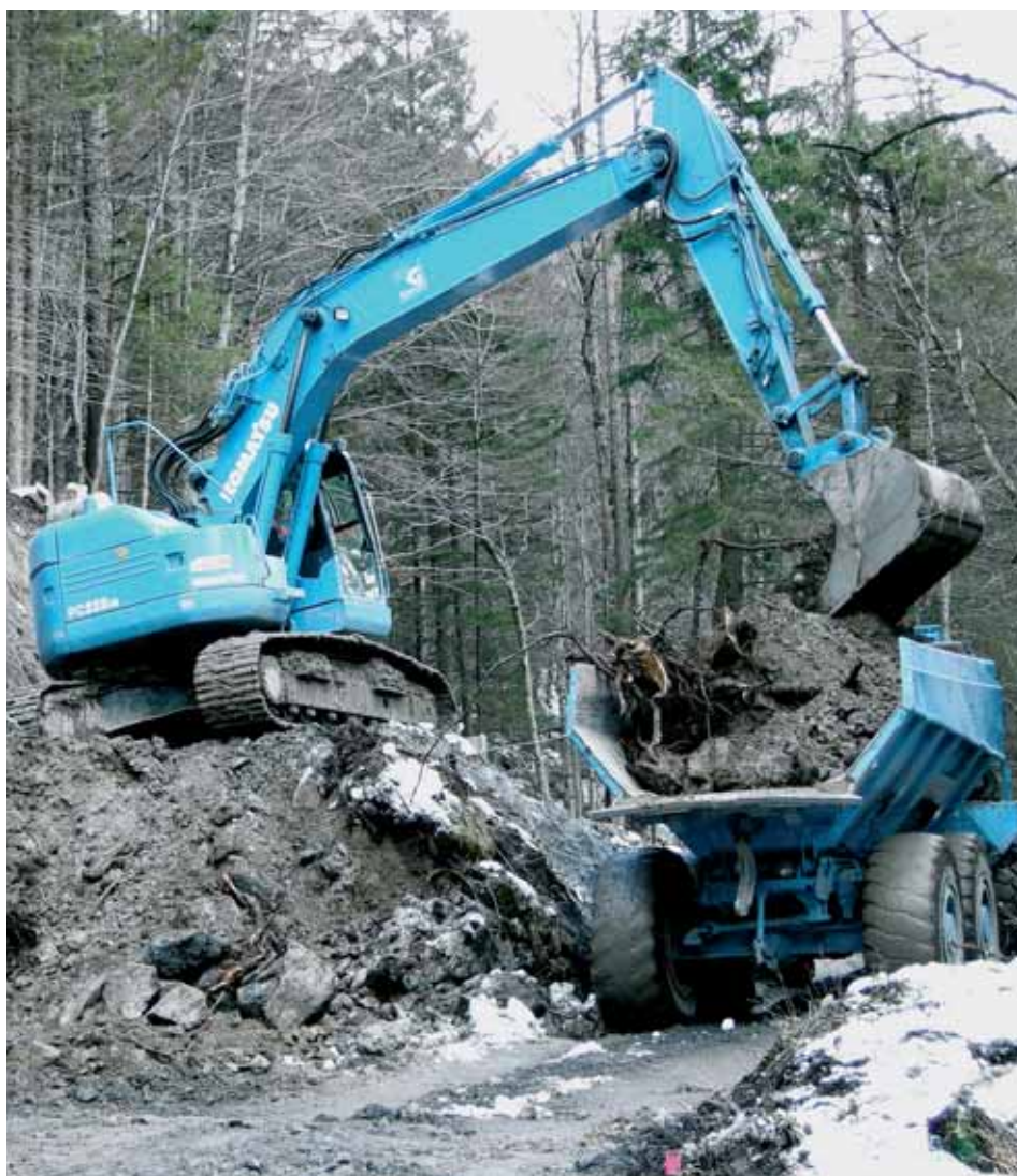
Materialabtrag Wendeplatte Paradiesli.
