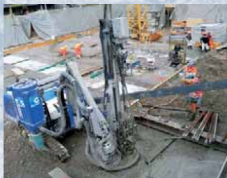
► Instabile Kranfundation Luzern
