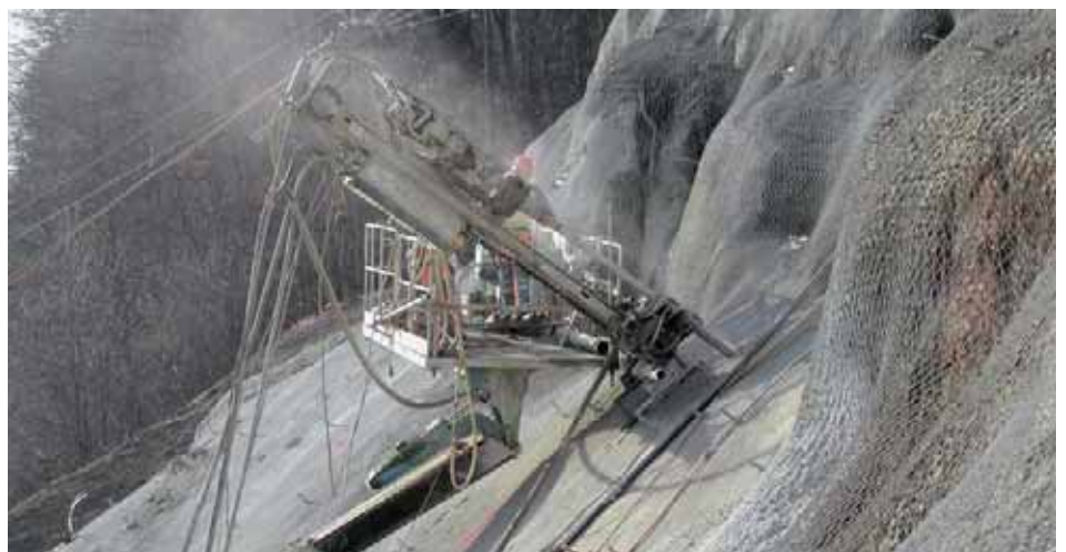
Verrohrte Bohrung für Nägel Schutzstufe 2 und 2'500m 2 schwere Netzabdeckungen.
