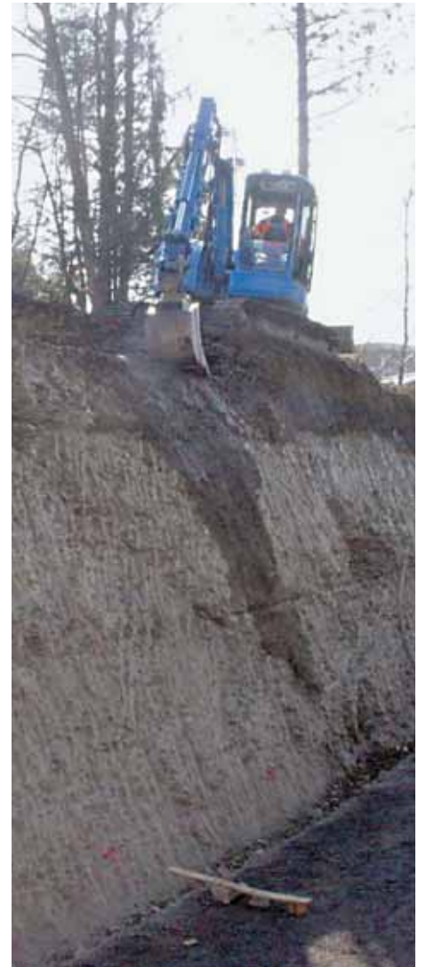
Hangsicherung mit Netzabdeckung.
