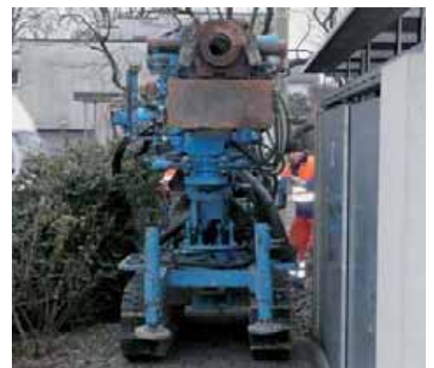
Baustellenzufahrt, weniger als 1.40m breit.
