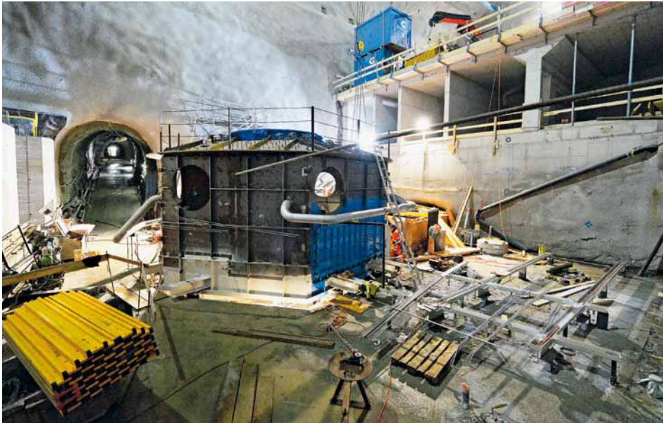
Maschinenblock mit Turbinengehäuse.
