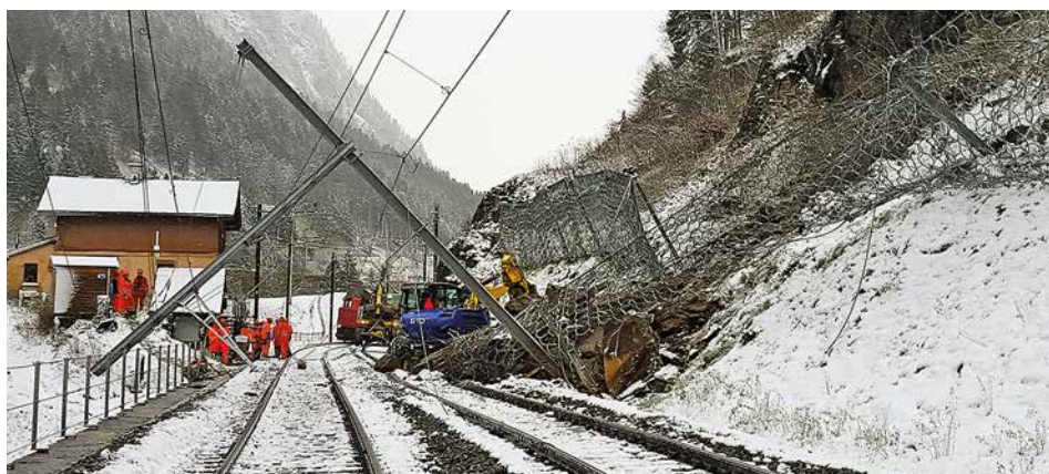
Ereignisstelle mit umgekipptem Fahrleitungsmast auf der SBB-Gotthard-Strecke
