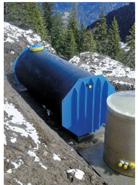
Wasserreservoir mit Entkeimungsanlage
