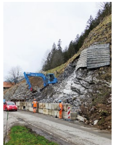
Felsabtrag ohne Schutzwand
