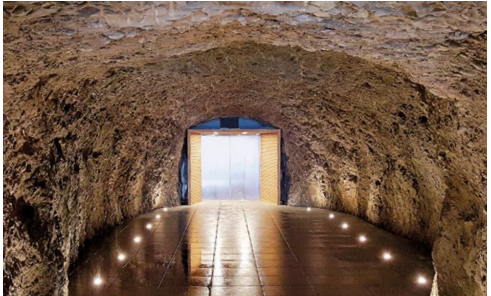
Ausgebrochene Nische vor dem Liftschacht
