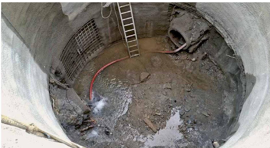
Blick in den runden Schieberschacht mit dem Grundwasseranfall
