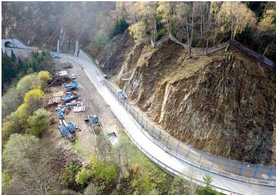
Temporärer 50-kJ-Schutzzaun sichert die Fahrbahn
