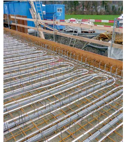
Decke mit Betonkerntemperierung
